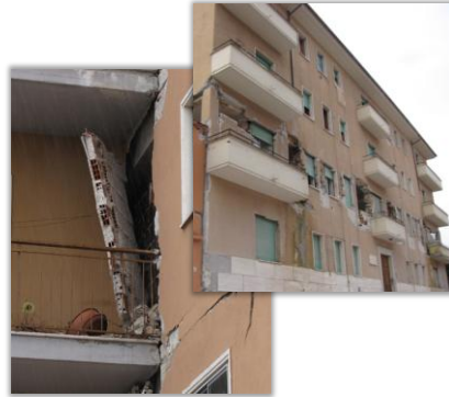
Espulsione del paramento esterno di tamponamento di un telaio in c.a.
