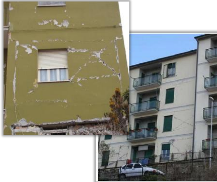
Fessure Diagonali sui tamponamenti di un telaio in c.a.
